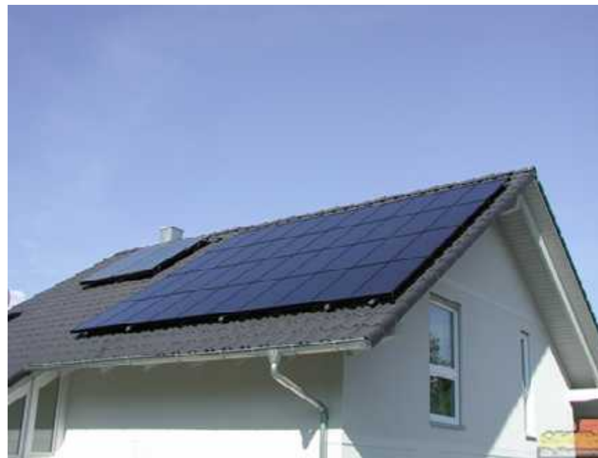
太阳能光伏系统
